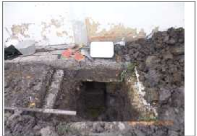
PROCESO APIQUE, E IDENTIFICACION DE LOS ELEMENTOS
